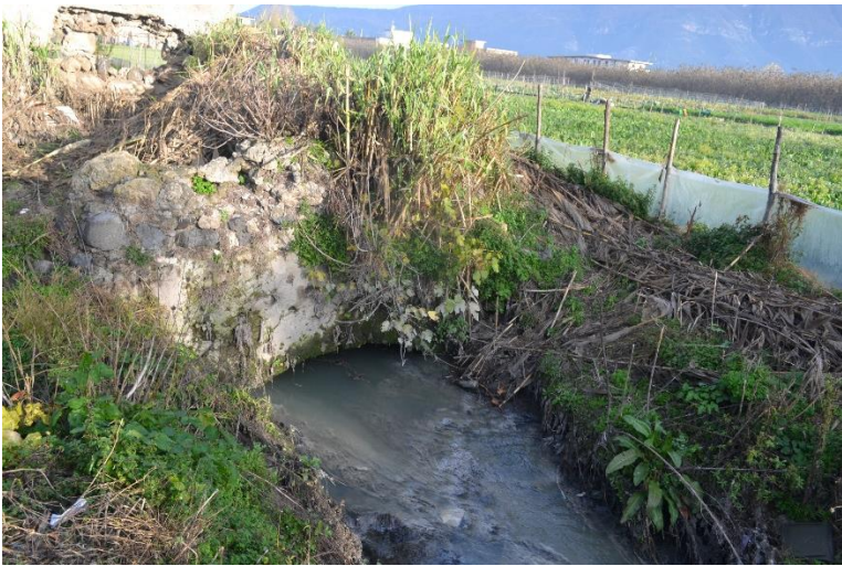
Canale Acqua alta
